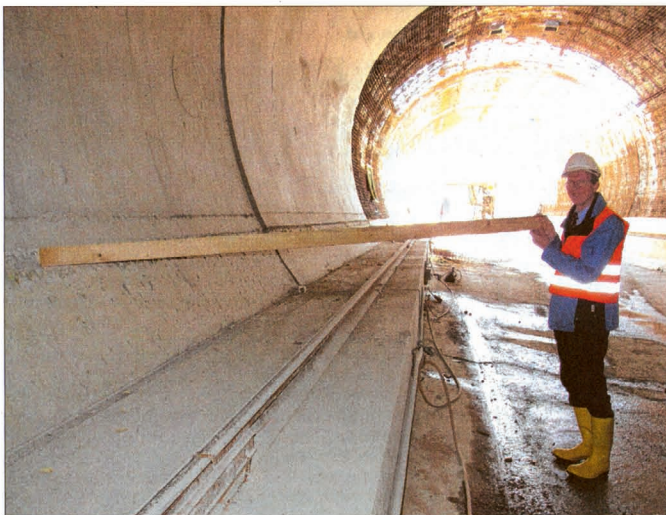
Projektleiter Vitus Danzl vom Staatlichen Bauamt zeigt die künftige Fahrbahnhöhe im Tunnel.
